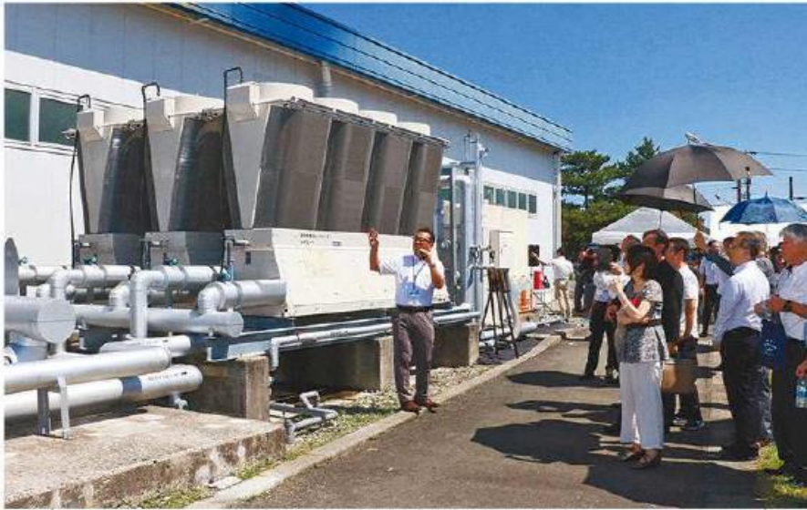
地中熱・地下水熱を活用した空調設備 の説明をする担当者＝袋井市国本で
